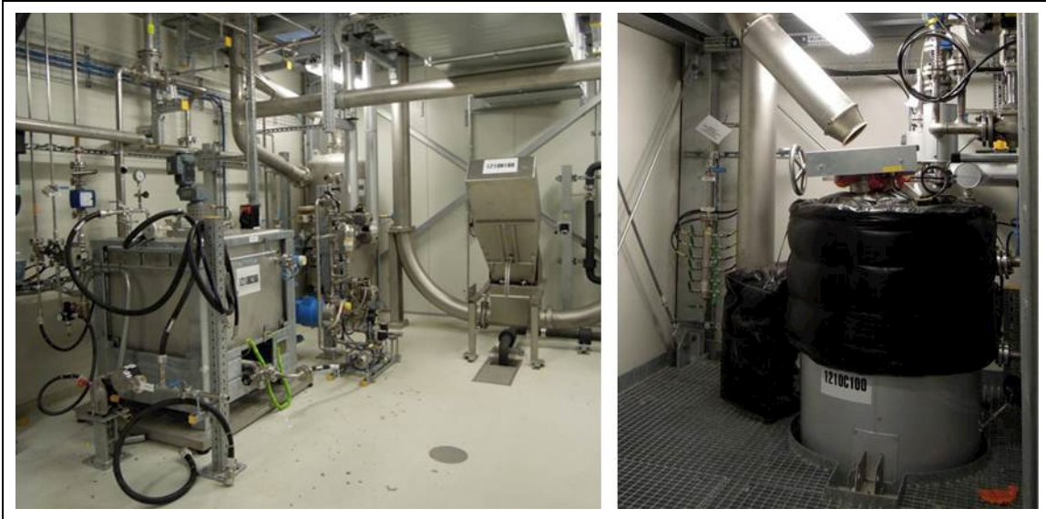
Abb. 71: Teilanlage 1210 Holzaufschluss. Links: atmosphärischer Vorlagetank B200 mit Hochdruckpumpe sowie Holzaufgabe Rohrkettenförderer. Rechts: Aufschlussreaktor C100. (Quelle: CBP)
