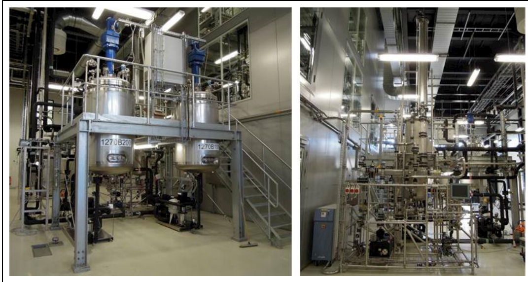
Abb. 75: Links: TA 1270 Cellulosehydrolyse mit den beiden Rührreaktoren. Rechts: TA 1280 Eindampfung (Quelle: CBP)
