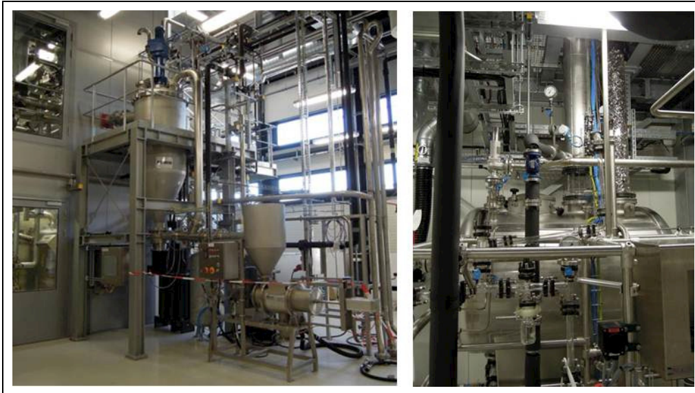
Abb. 74: Links: TA 1240 Cellulosewäsche und -entwässerung mit Waschbehälter und Schneckenpresse. Rechts: TA 1250 Lösemittelrückgewinnung mit Destillationssumpf, Verdampfer und unterem Kolonnenteil (Quelle: CBP)
