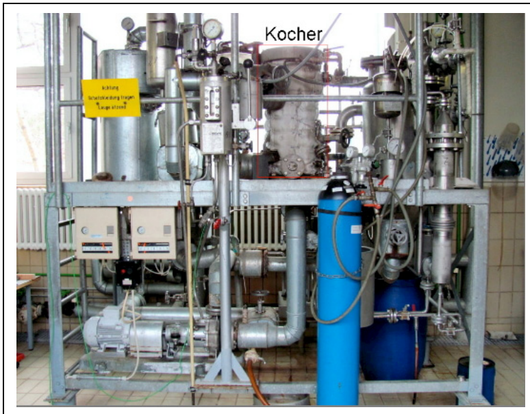
Abb. 46: Versuchsanlage Uni-HH/TI (Quelle: BTS)
